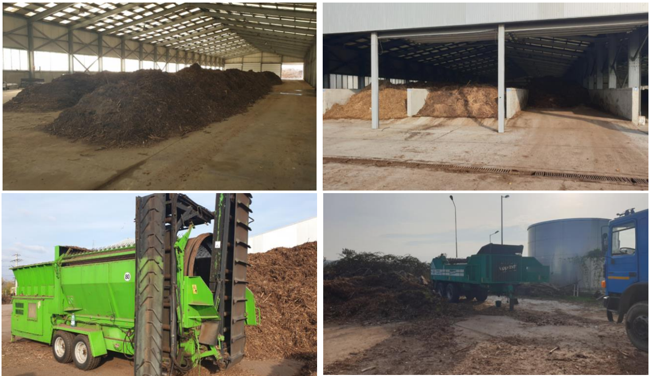
Figura 4.14. Stația de compostare Râureni
