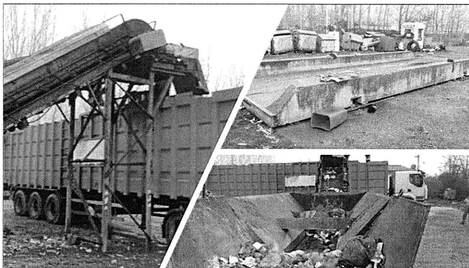
Figura 4-2: Echipamente tehnologice stație de transfer Brezoi
